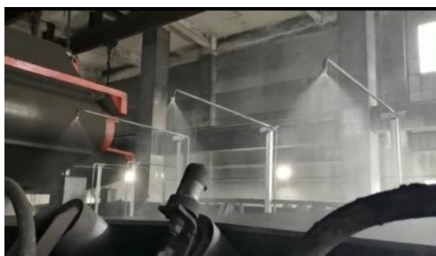
转运站水喷淋设施
